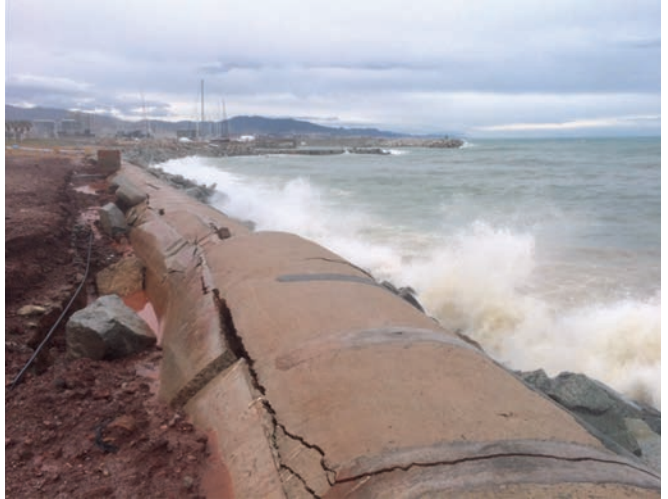
Estat del col·lector d'aigües residuals a la platja de la Mora
