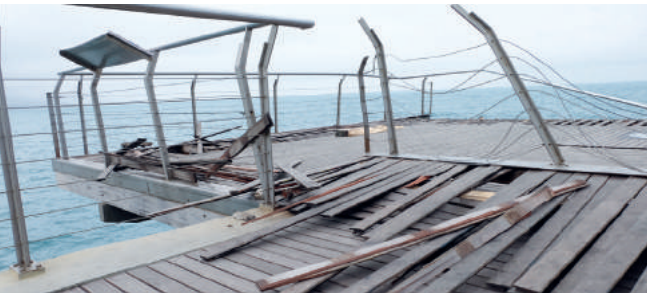
Imatge de les destrosses al Pont del Petroli
