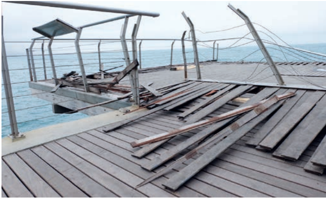
Imatge dels desperfectes del Pont del Petroli
